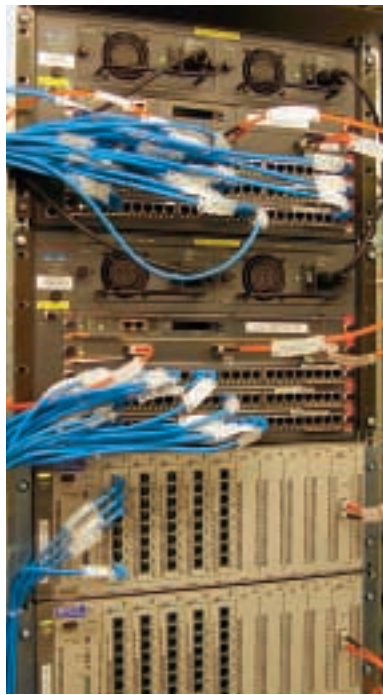
Sauber verlegte Kabelstränge bringen Ordnung ins Rechenzentrum.
